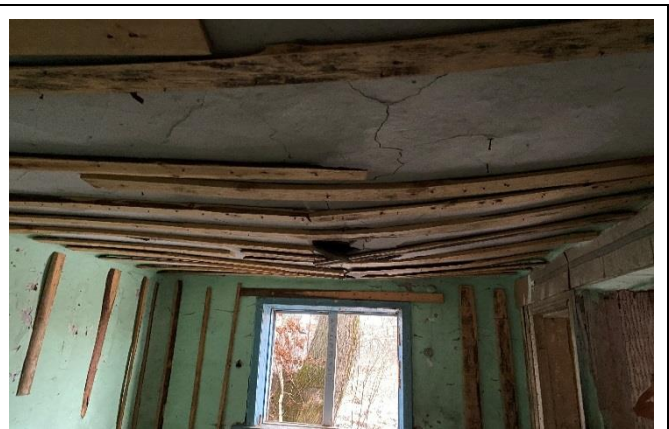
фото прогиба перекрытия
