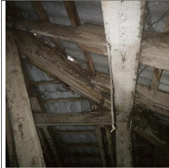
поражение гнилью конструкций
