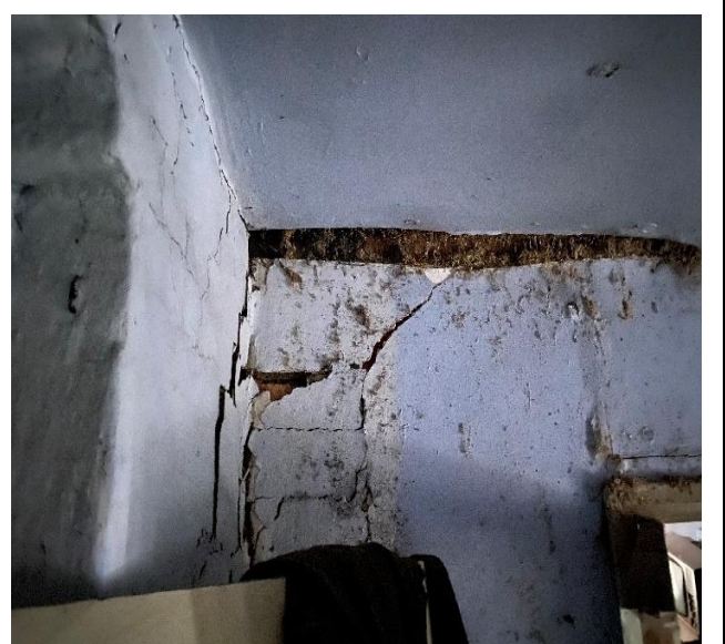
трещины в местах сопряжения перекрытия и стен
